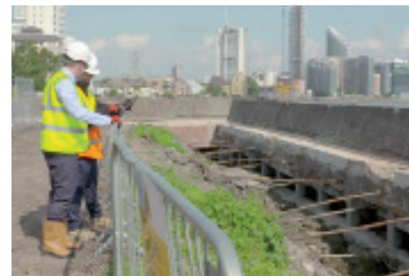
Использование 3D-моделирования, мобильных и облачных технологий позволяет сотрудникам компании Hill проводить больше времени на строительной площадке и быть более продуктивными. © Hill.
